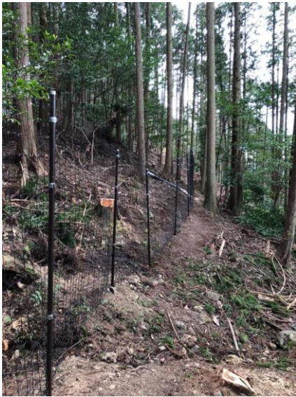
千代田池左岸、付け替え設置された獣害防護柵
